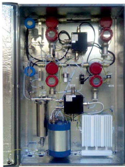
Комплект газоаналитического оборудования для мониторинга выхлопных газов ГПА на основе датчиков ДАХ-М-09-СО-500/-09-NO-200/-09-О 2 -21
